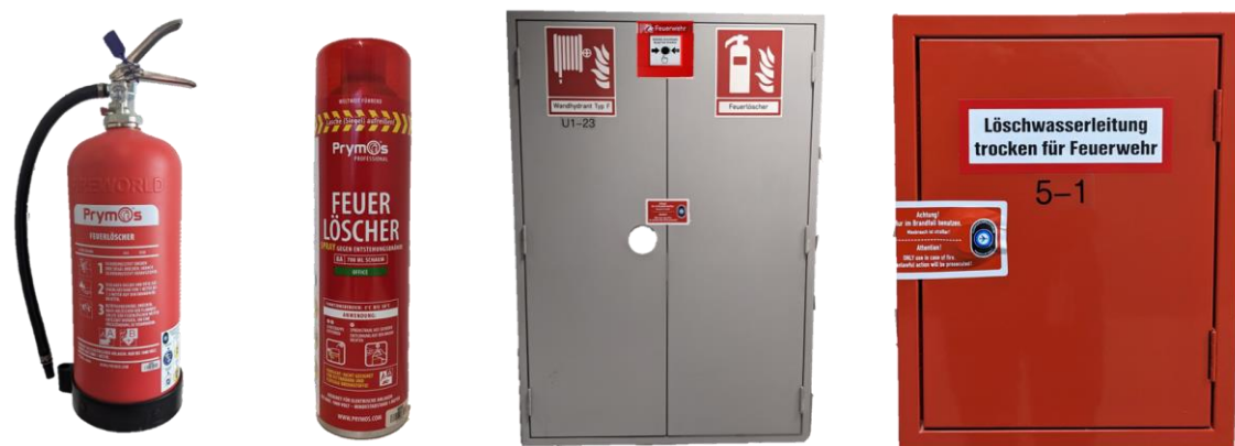
Abbildung 10: Feuerlöscher (FL), Löschspray, Wandhydrant mit integrierten HFM und FL, Steigleitung Feuerwehr
